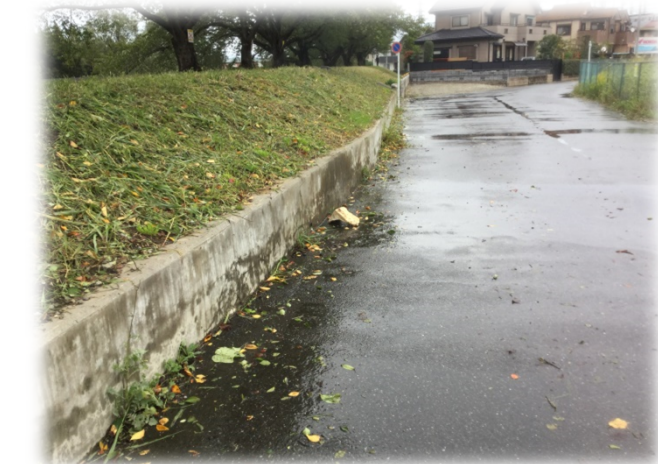
(水が染み出ているコンクリート部分)
