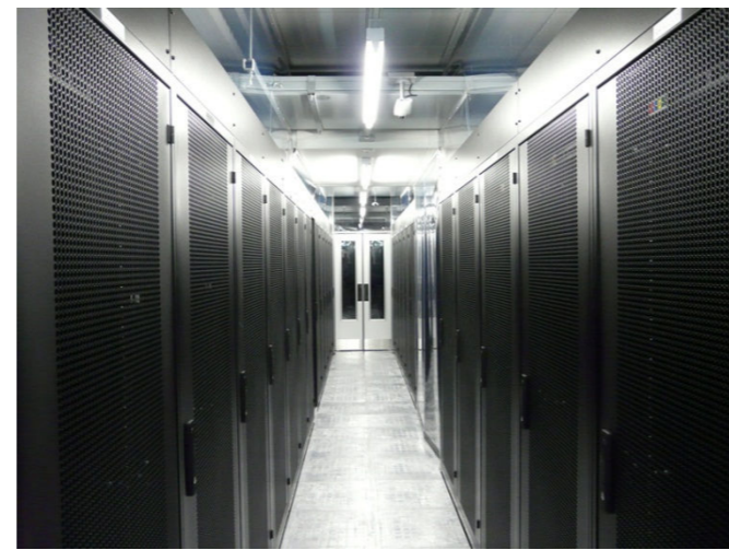
新本庁舎建設の際には、大切なデータを守るコンピュータールームのあり方も考える必要がある。
